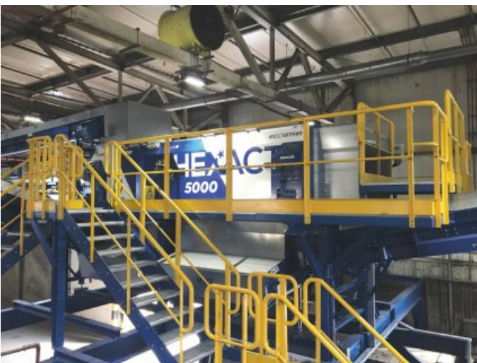
Przesiewacz Hexact 5000 na instalacji RDF.
